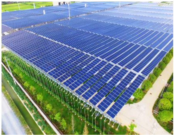
▲ 浏阳经开区北园再生水厂6.5MW 分布式光伏发电项
