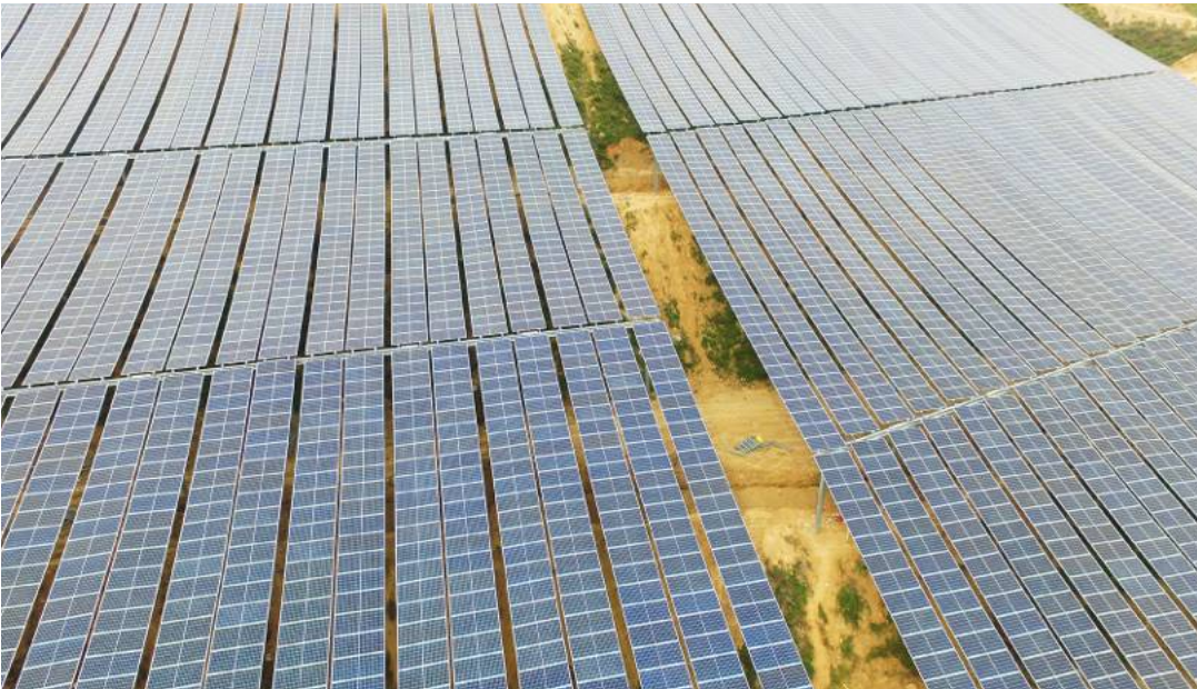
山西交口县300MW山地光伏项目 ▲
