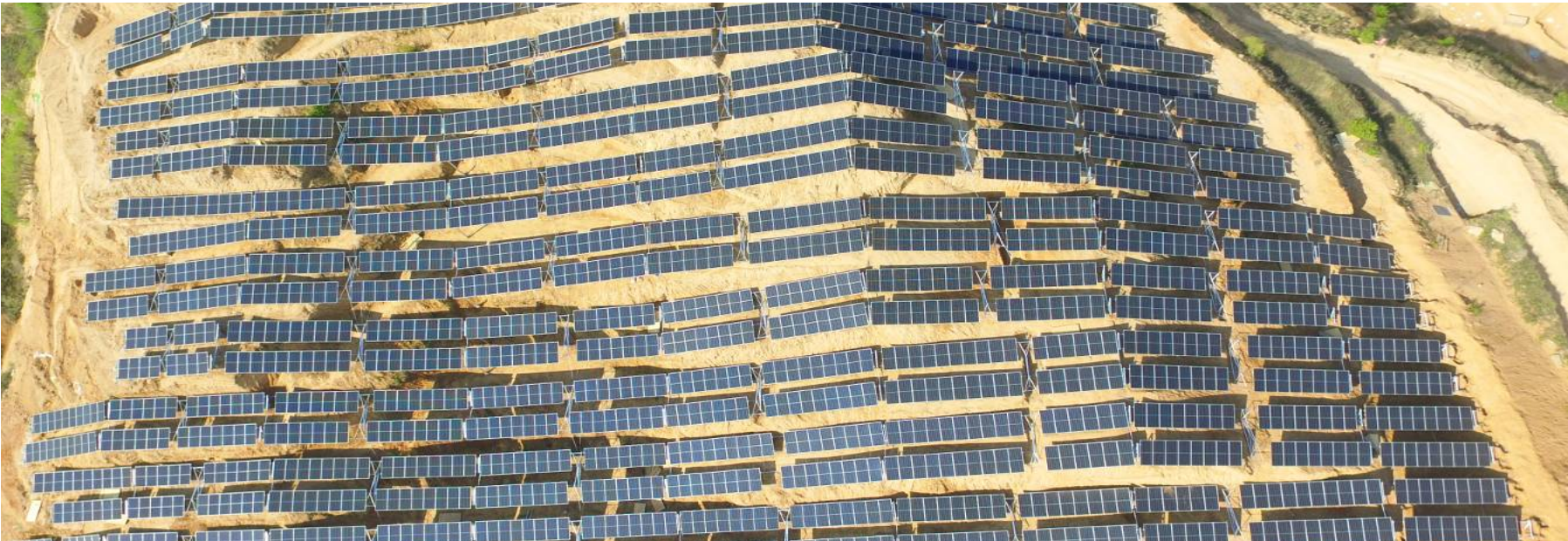
▲ 山西省运城市闻喜县礼元镇100MW光伏项目
