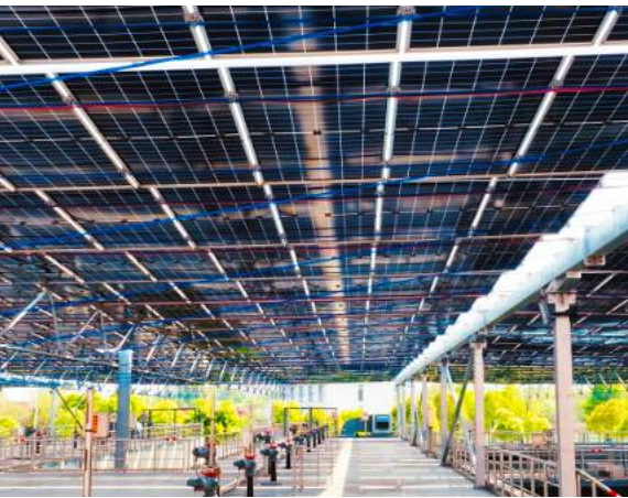
▲ 上海城投竹园污水处理分公司二期8.18MW 分布式光伏发电项目
