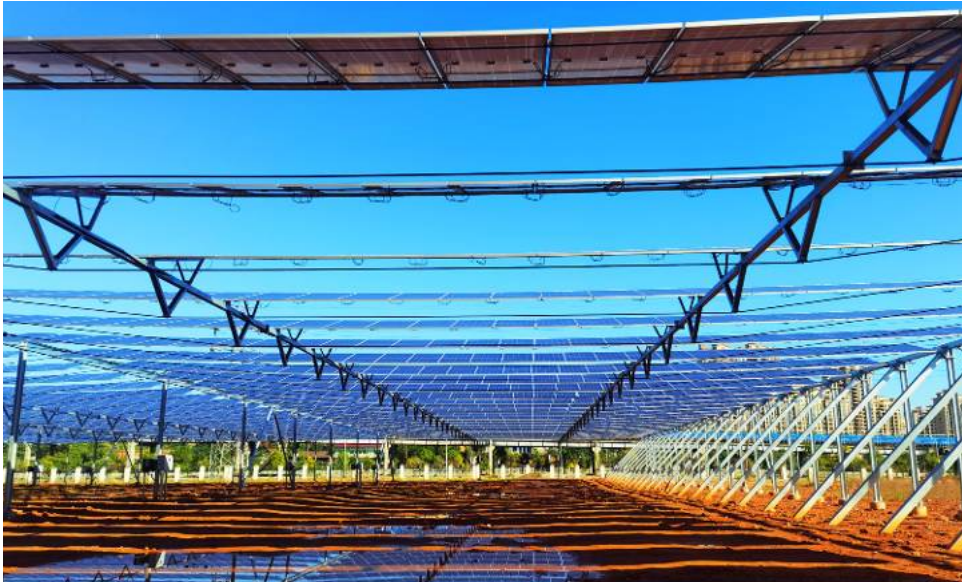
▲ 贵溪电厂光储充一体化智慧能源项目设计、采购、施工EPC总承包
