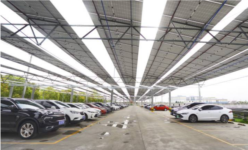
▲ 南通中天电气停车场柔性光伏支架项目
